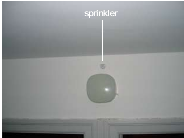
"sidewall" sprinkleren i trapperummet fylder kun 5 x 5 millimeter.
